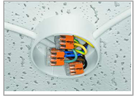
Leuchtenverteilung in Deckenbaldachin
