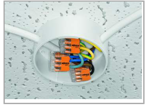
Leuchtenverteilung in Deckenbaldachin
